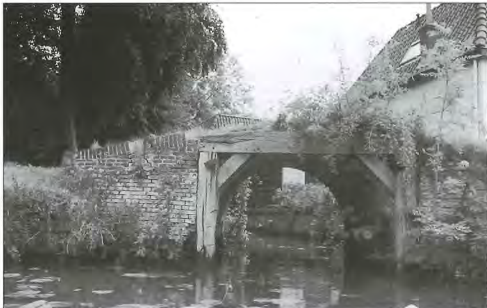
Afb.3. Het brugje in het Zandpad bij Vechtoever. Aan de Vechtzijde is nog iets te zien van de ophanging van de sluisdeuren. De toestand van het metselwerk, vooral in de onderdoorgang, baart zorgen.
