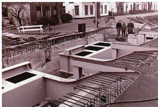
Onder de brugvloer de kelder met contragewichten en bedieningsmotor van de brug.
