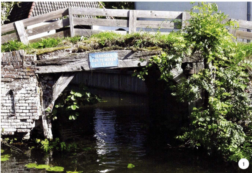
Het verwaarloosde bruggetje in het zandpad tussen Vechtoever en Goudestein.
